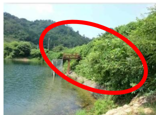
① 堤体に草が繁茂
