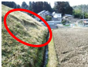
② 堤体の一部が沈下
