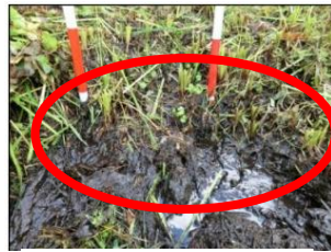
③ 堤体から漏水
