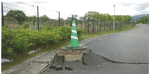
※隆起したマンホール（益城町）
