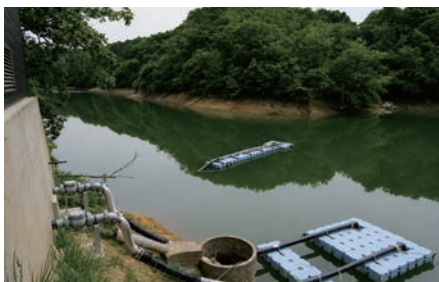
勝田池の取水施設
