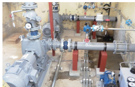
勝田池のポンプ
