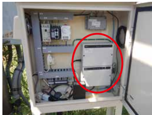
除塵機水位監視システム導入(省力化)
