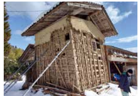
農業集落の被災状況
