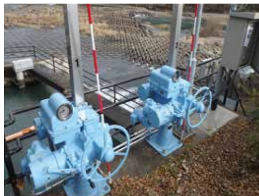
樋門電動化(省力化)
