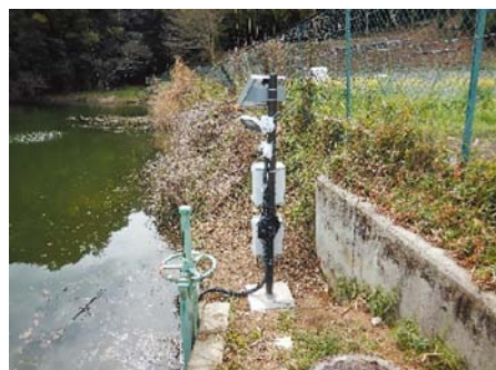
設置例（水位計とカメラ）
