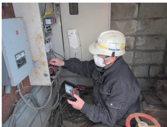
操作盤の診断
