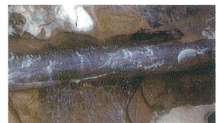
(パイプラインの漏水)
