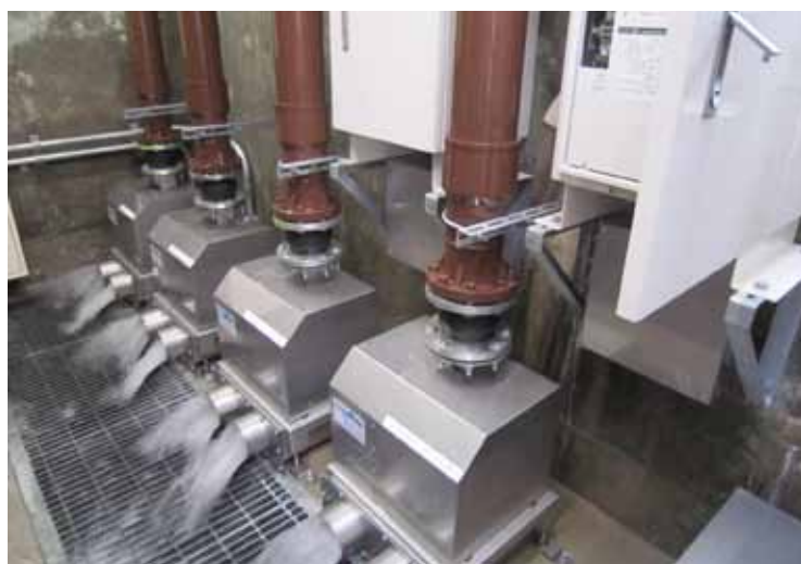
南丹市美山町で設置された小水力発電施設（環境省補助事業）
